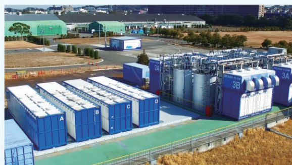
当社横浜製作所のレドックスフロー電池
