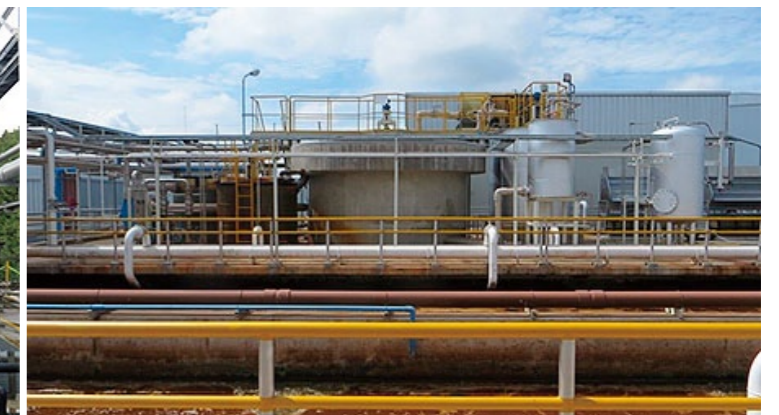
タイ工場の排水処理装置
