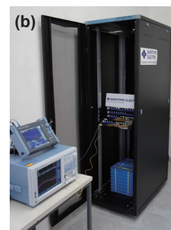
(a) 端末終端後のMCFケーブルの構成 (b) ケーブル両端を収納した19インチラック光パネル
